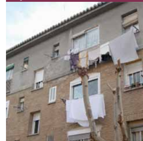
Estado de la fachada de vivienda dentro de un Conjunto urbano. Zaragoza État de la façade d’un logement dans un Ensemble urbain. Saragosse
