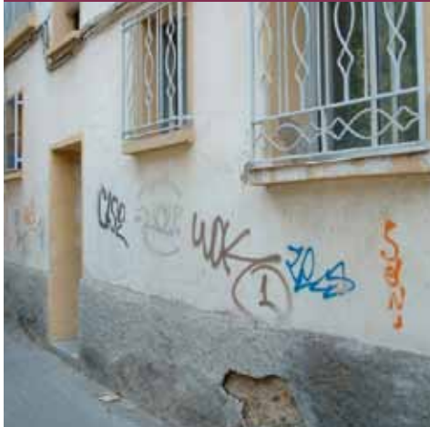
Estado de fachada de vivienda en Conjunto Urbano État de la façade d'un logement dans un Ensemble urbain.
