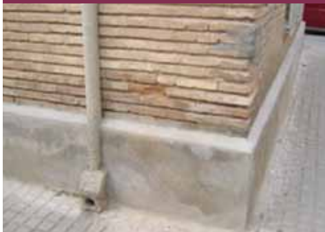
Bajante Conjunto Urbano Zaragoza Canalisation de descente de l'Ensemble urbain de Saragosse
