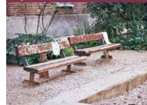
Falta de mantenimiento de espacios comunes. Conjunto urbano, Zaragoza Entretien insuffisant des espaces communs. Ensemble urbain, Saragosse
